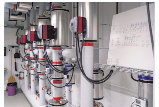
L'intérieur du nouveau bâtiment du collège d'Oron, construit en 2021. Ce système centralisé permet de chauffer l'ensemble des quatre bâtiments depuis deux chaudières. C'est ce que l'on appelle, un chauffage à distance.
